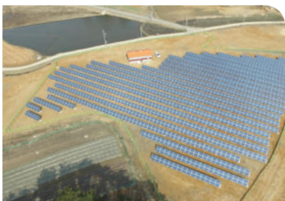
대웅 태양광발전소 500kW
