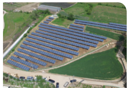
금빛 태양광발전소 450kW
